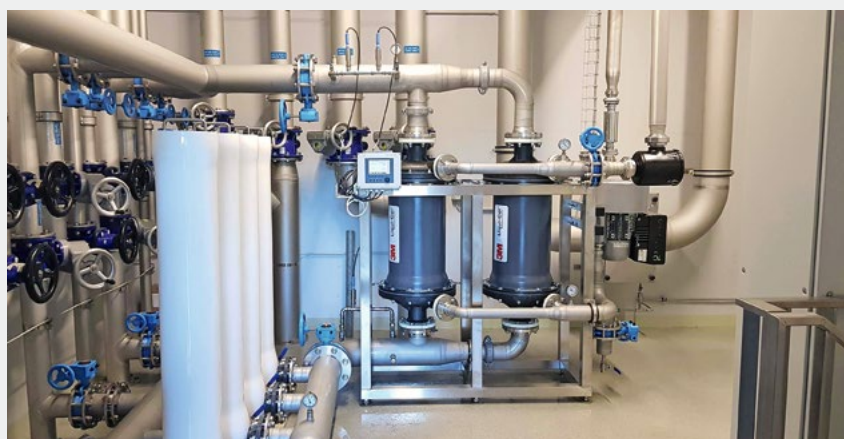
Fig. 7 Photo de l'installation de dégazage du réservoir de Bursins, sur le réseau ouest du SIDERE.
